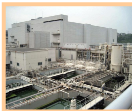
排水処理設備
